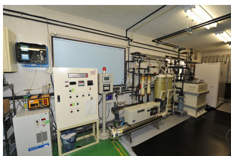
【当社 R&D センター超純水製造設備】
